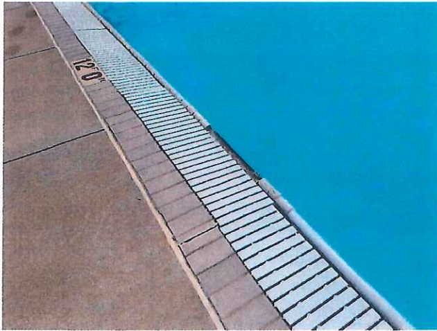
21. BROKEN GUTTER BULLNOSE
