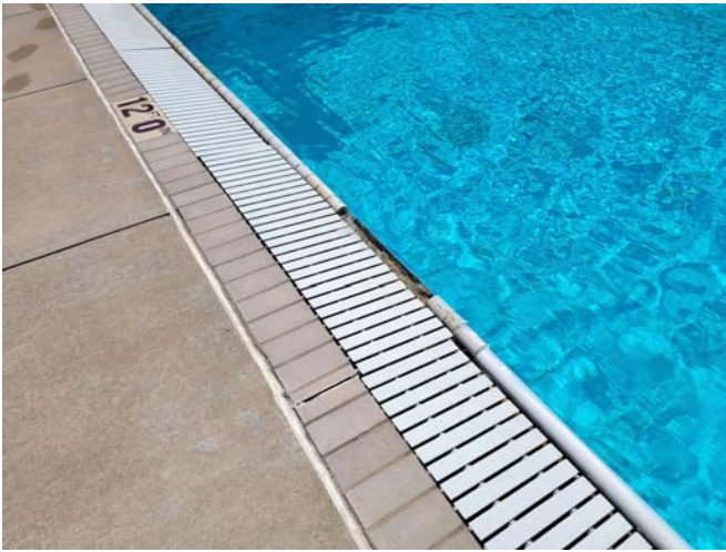
21. BROKEN GUTTER BULLNOSE
